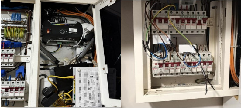
Şekil 20. Bayrampaşa’daki enerji tüketim sayaçları
