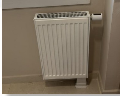
Şekil 18. Bayrampaşa’da akıllı termostatik vana kurulumu
