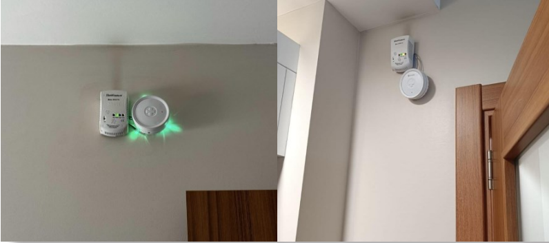
Şekil 19. Bayrampaşa’daki IAQ sensörleri ve HVAC kontrolörleri
